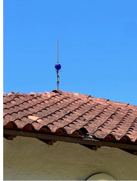
Item 3 – Lightning Rod
